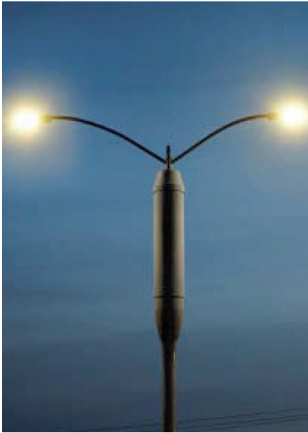
BILD 4: „Smart Light Pole“ von Philips (Foto: Phillips)
